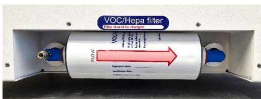
Figura 12.3 Filtro VOC/HEPA installato correttamente
